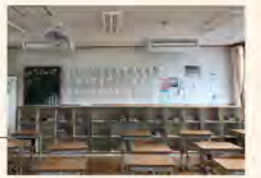
中学校の教室に整備されたエアコン
