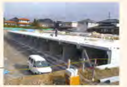
赤妻2号雨水貯留施設
